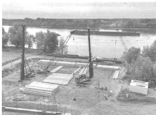
Rys. 5. Roboty palowe w fundamencie podpory 13/14 od strony centrum Torunia; widoczny magazyn pali i kafary z młotami hydraulicznymi w trakcie wbijania pali
