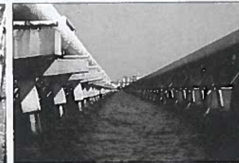
Rys. 38. Estakady rurociągów w Porcie Północnym (Aqua-projekt Gdańsk)
