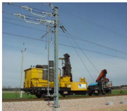
Fot. 2. Pale prefabrykowane jako fundamenty słupów sieci trakcyjnej i pale kotwiące odciągi na przebudowanym torze
