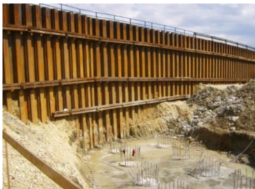
Fot. 11. Zabezpieczenie wykopu dla wykonania fundamentów i zwieńczeń budowanego wiaduktu – 11,5m ( www.geoinzynieria.com )
