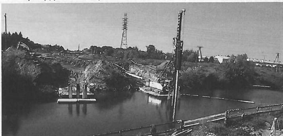
Rysunek 17. Palowanie fundamentów podpór tymczasowych w korycie Wisłoka [5] z tymczasowej grobli przy użyciu kafara z młotem hydraulicznym
