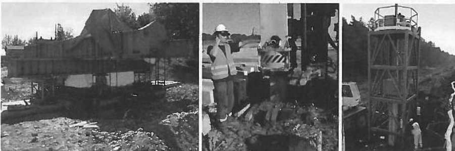
Rysunek 5. Badania nośności pali statyczne (po lewej), dynamiczne przy dużych odkształceniach z wykorzystaniem kafara (w środku) i z wykorzystaniem bijaka urządzenia przenośnego (po prawej)
