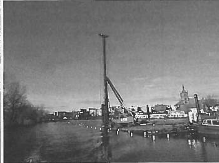
Rysunek 8. Wbijanie rur stalowych pod pomost spacerowy na jeziorze Chełmżyńskim przy użyciu kufara na platformie pływającej
